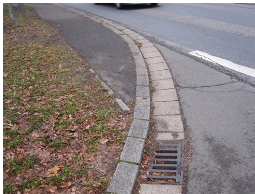
Abbildung 16: Fehlende Bordsteinabsenkung Bahnhofstraße
