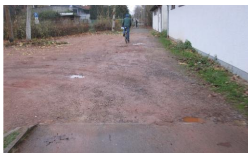
Abbildung 19: Unterbrochener Radweg am Sportplatz
