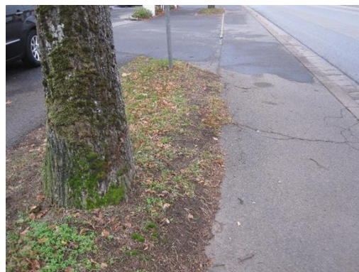
Abbildung 17: Wurzelschäden in der Bahnhofstraße
